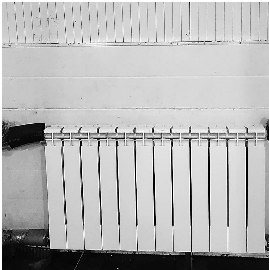
Фото 5. Подключение снизу - вверх боковое.
