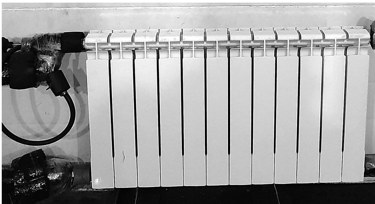
Фото 6. Подключение снизу - вверх боковое. Удлинитель потока вставлен слева (верх) радиатора на выходе теплоносителя.
